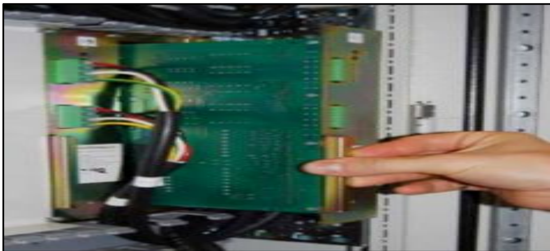
Figura 41: Centro de Distribución de potencia (PDC) Fuente: (ASTAP, 2019)
