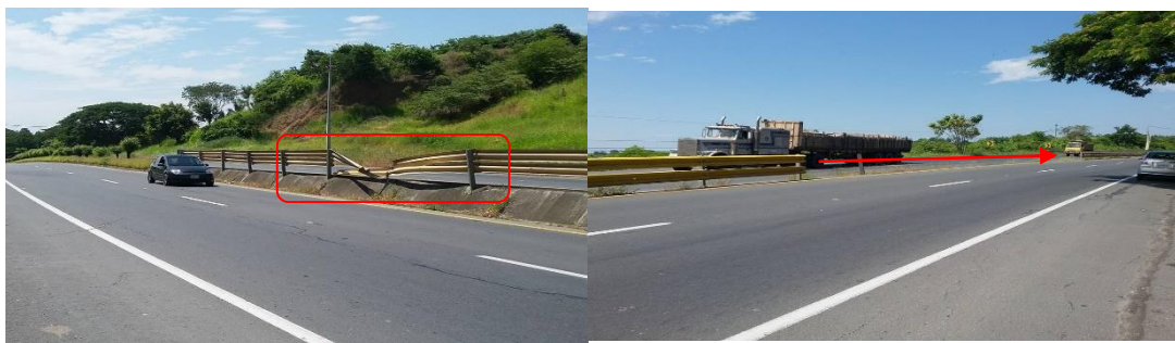
Ilustración 19. Falta De Mantenimiento y Continuidad En Guardavía
