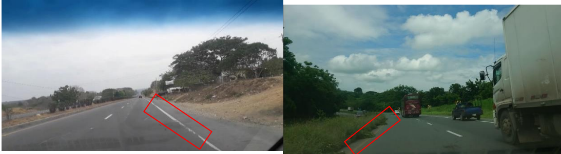
Ilustración 6. Pintura De Señalización Horizontal Desgastada
