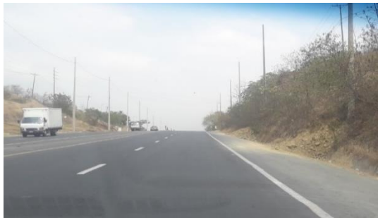
Ilustración 12. Material Suelto En La Calzada Tomado por: Alvarez Barrionuevo A. (2019)
