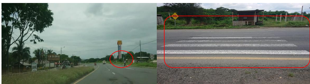
Ilustración 10 Mala Retro reflectividad En Señalización Horizontal Tomado por: Alvarez Barrionuevo A. (2019)
