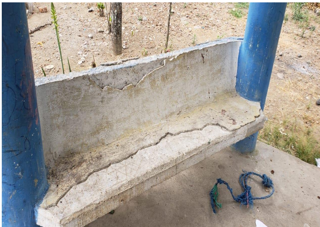
Ilustración 1. Banca deteriorada en parque 1 coop. 24 de mayo
