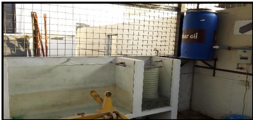
Ilustración 1 Limpieza del Humedal Artificial subsuperficial horizontal y tanque de almacenamiento del agua residual doméstica.
