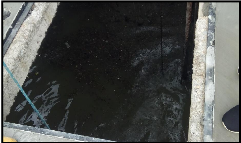
Ilustración 12 Cisterna de Aguas Residual Domestica
