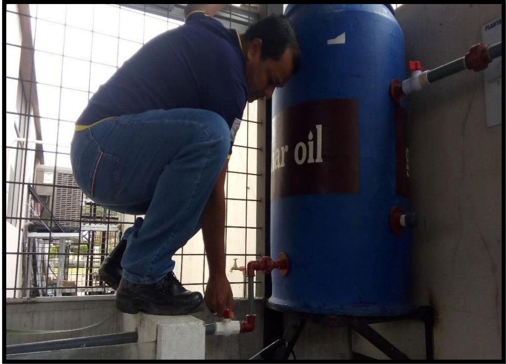
Ilustración 11 Abertura de válvula para que ingrese el caudal inicial de Aguas Residual Doméstica
