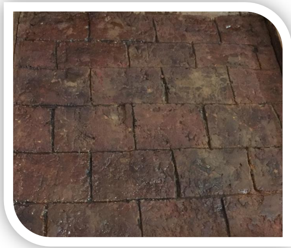
Fotografía 52. Piso Decorativo de Argamasa del Terreno y Cemento Utilizando Pigmento Mineral con Poca Humedad Rectificado con Tinte Para Madera. Fuente: Fotografía Tomada por Priscila Román, (2018)
