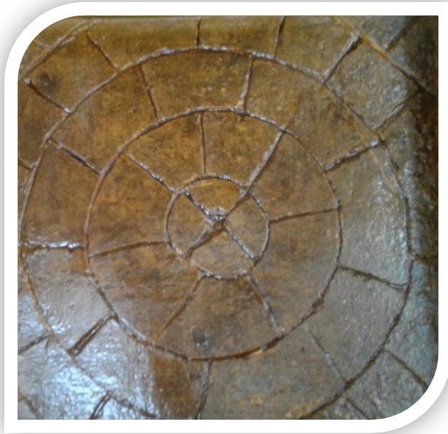
Fotografía 65. Piso Decorativo con Argamasa del Terreno y Cemento, Acabado Tipo Adoquín Café Claro.
