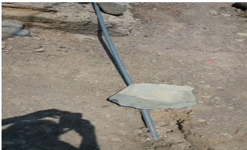
Foto 2: Tubería PVC domiciliar del sector de Barrio Lindo
