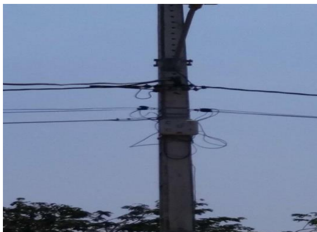
Foto 5: Servicio de telefonía por cable de CNT
