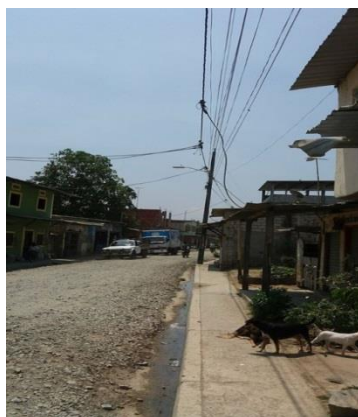
Foto 6: El servicio de Energía Eléctrica por CNEL EP, Medidores digitales de Energía, Cableado aéreo y Transformadores de corriente
