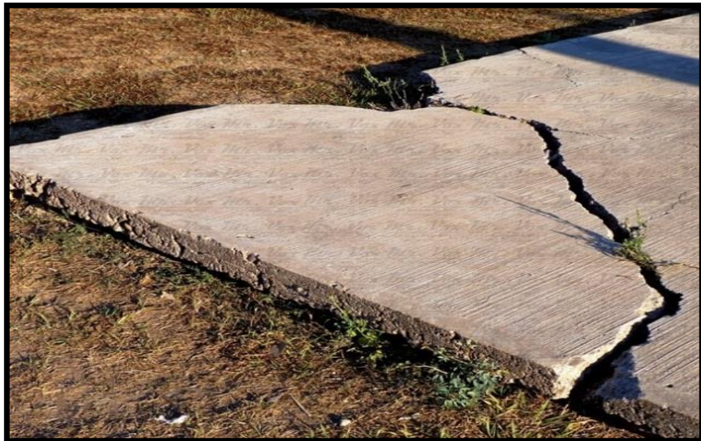
Ilustración 2: Cancha en mal estado, hormigón deteriorado
