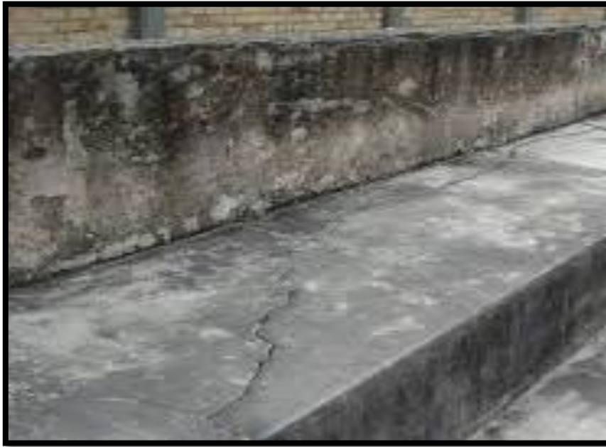
Ilustración 3: Graderíos en mal estado
