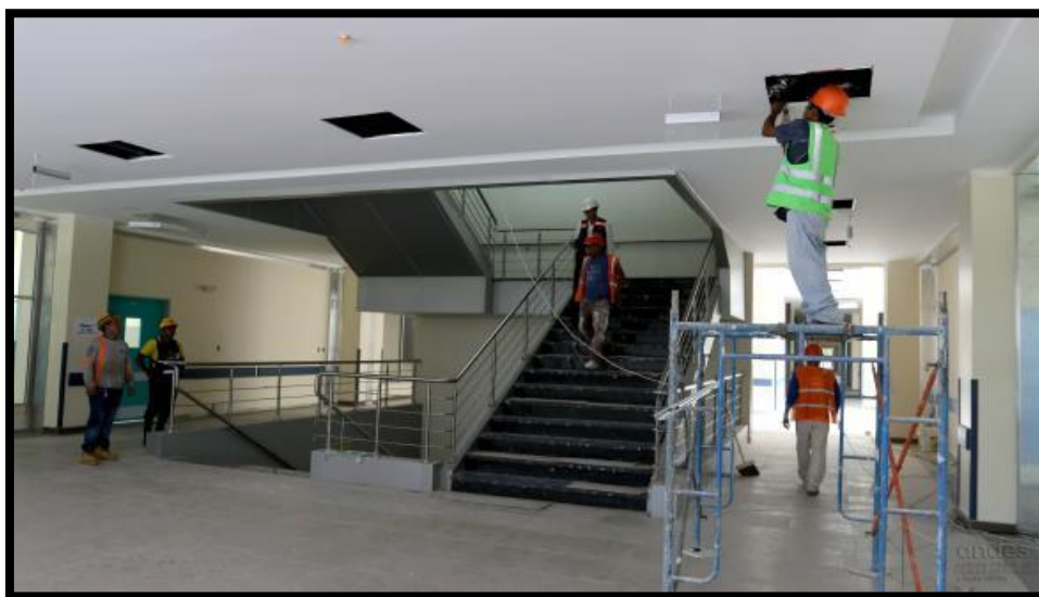
Figura 2 Instalaciones de acondicionadores del aire en un Hospital Público de Guayaquil
