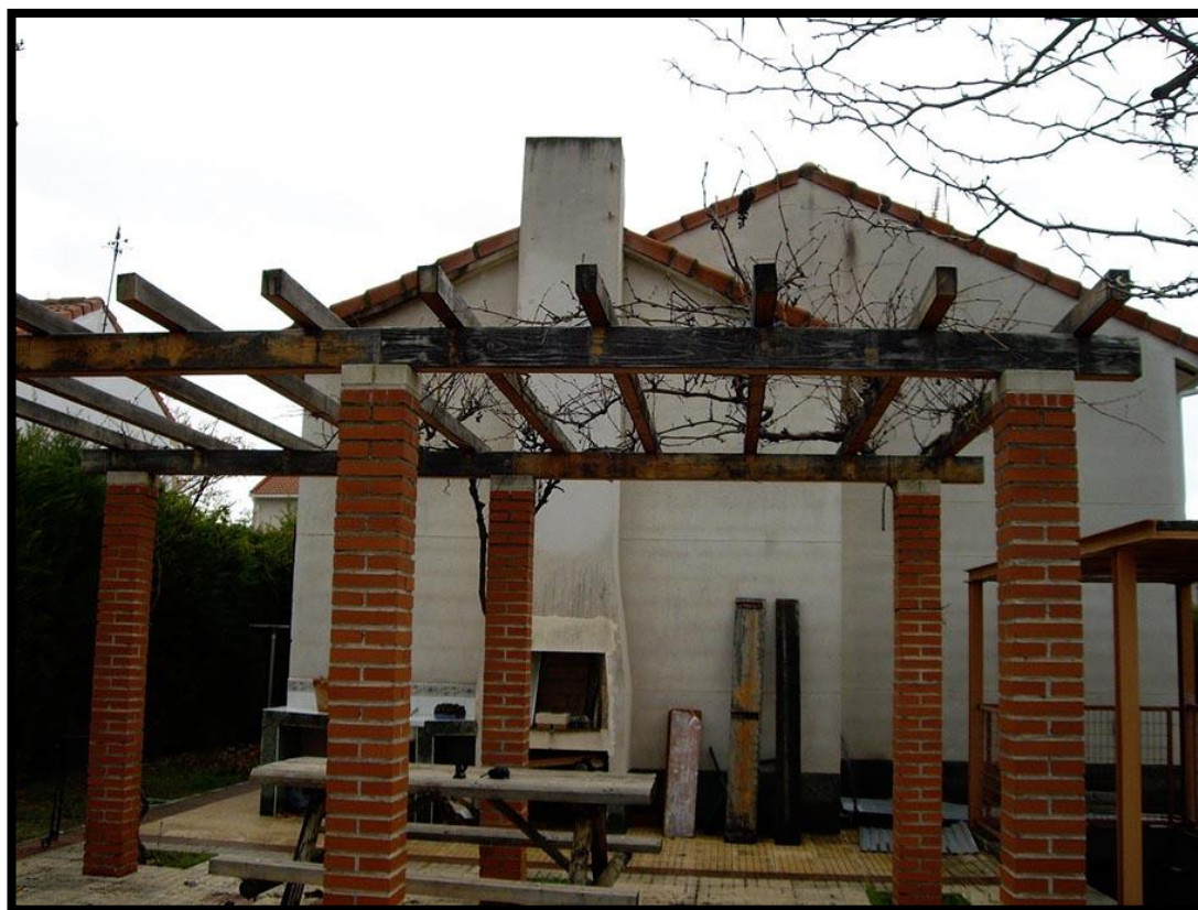
Figura 12 Pérgolas de Madera
