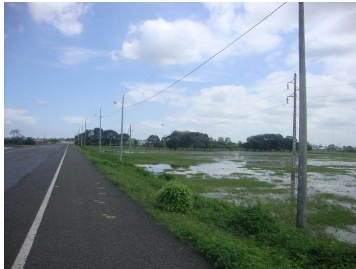
Fotografía 28: Red eléctrica ubicada en el terreno destinado al terminal terrestre. Fuente: Fotografía realizada por el autor.
