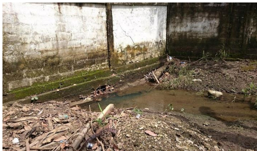
Figura 3. Drenaje posterior del centro Gerontológico
