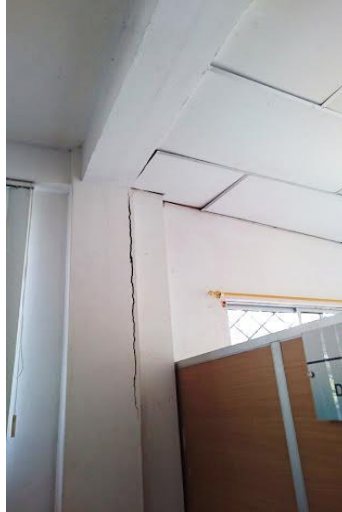
Figura 40. Grietas en pilar causada por terremoto, habitación de hombres.
