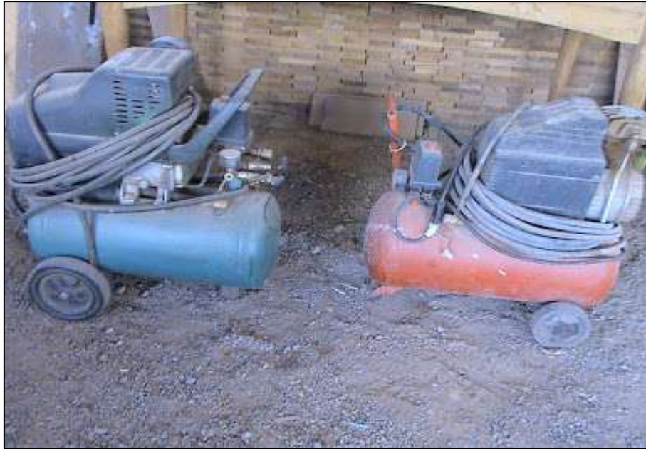
Figura 10. Compresor de aire Fuente: Espín (2017)
