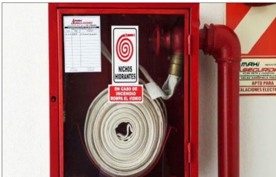
Figura 90 Boca de Incendio
