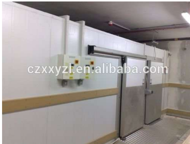
Figura 42. Maquinaria / Cámara de frio
