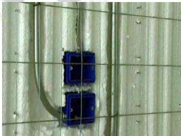
Instalaciones en pared
