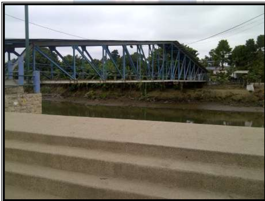
Paso peatonal sobre el río Yaguachi, desde el centro hacia poblados cercanos.
