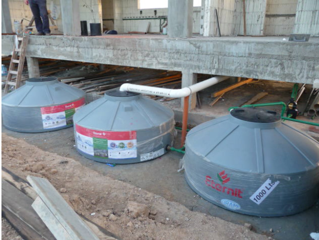
FOTO 15.- TANQUES DE RECOLECCIÓN DE AALL PRONACA.-
