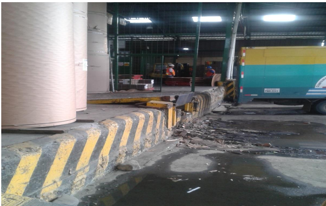
Figura No. 9 Muelle de Estibación y despacho de materia de producto terminado
